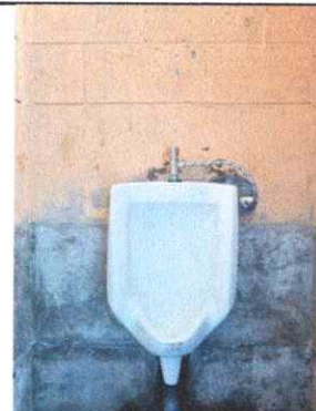
Foto 8: Sustrucción de llave en mingitorios, en área de Baños
