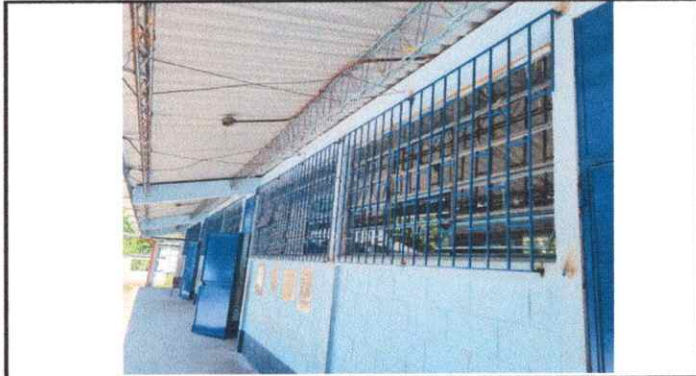
Foto 13 Fabricación e instalación de balcones de hierro en ventana, en modulo de Aulas
